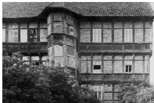
Abb. 55: Osterwieck, Rössingstraße 5 (Bunter Hof). Mit den Fassadenhölzern und Brüstungsbrettern des Nordflügels neu geschlossener Teil des Südflügels im Jahr 1990.
