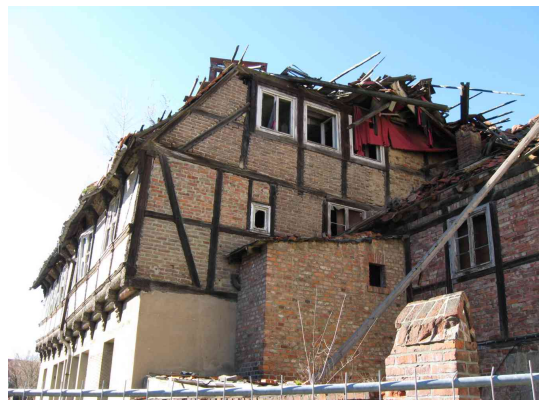
Abb. 51: Halberstadt. Bis heute gibt es viele historische Häuser, die akut vom Verfall bedroht sind, wie dieses Haus in der Straße Am Kulk.
