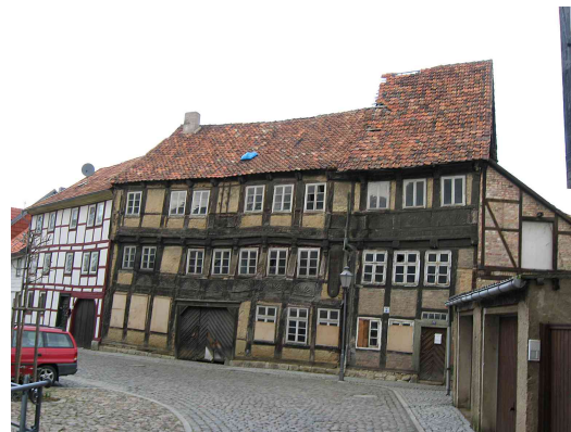
Abb. 63: Osterwieck. Der Zustand vieler Häuser in der Stadt ist nach wie vor bedenklich (hier Hagen 21/22 von 1580).
